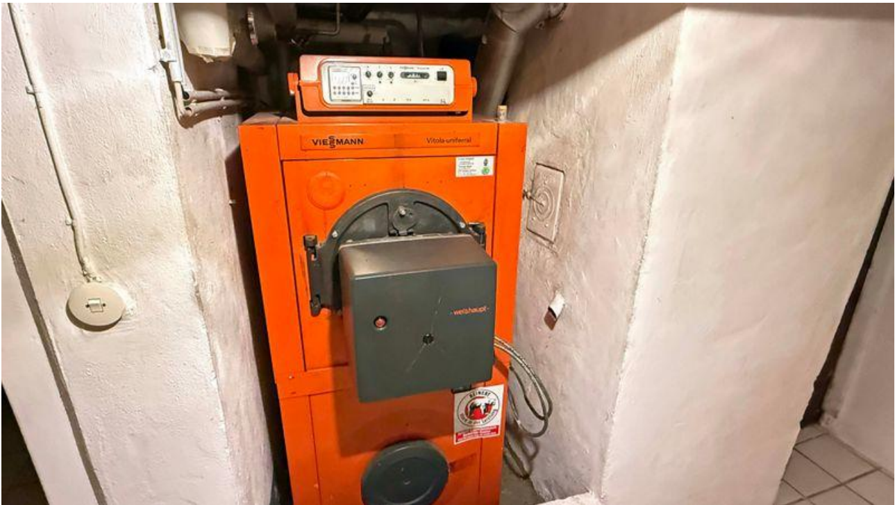
Ölheizung, Baujahr 1986, Brenner Baujahr 1999
